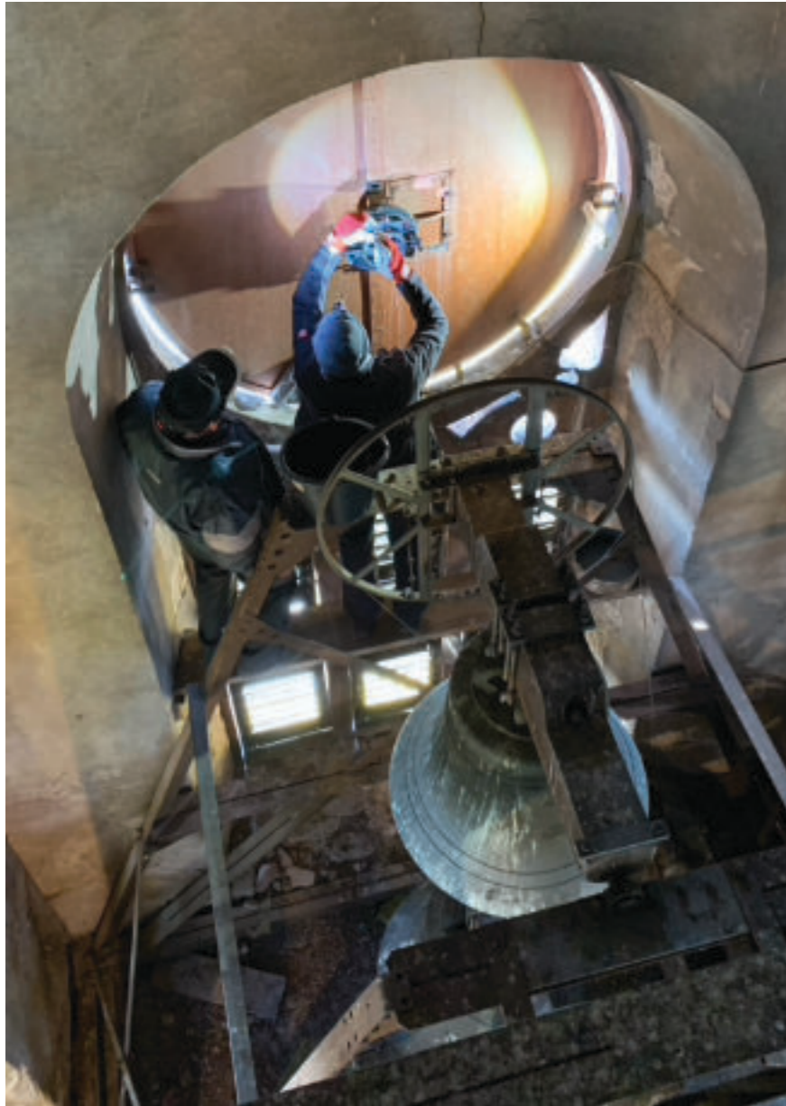
Austausch des defekten Teils der Uhr im Glockenturm
